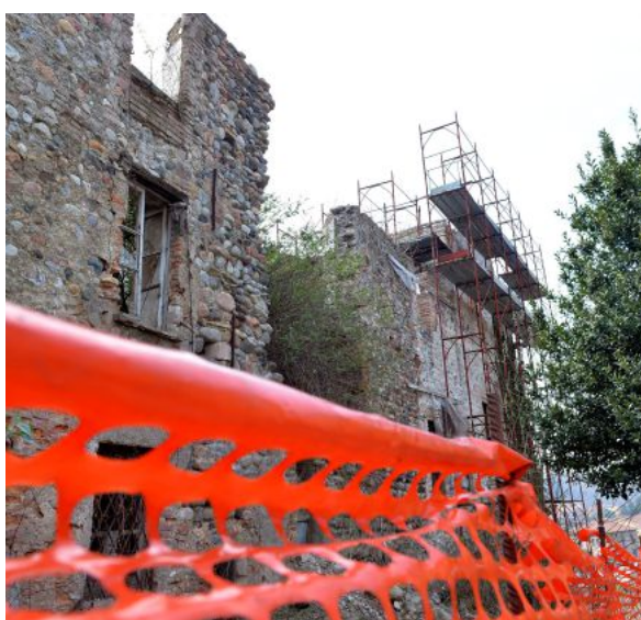
Il castello di Belforte versa in stato di abbandono, mentre la città si divide sull'ipotesi di restauro (foto Blitz)
